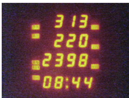
図3 デマンド監視装置の表示(23時撮影)
